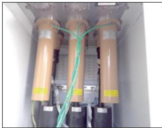
电缆室 Cable Room
